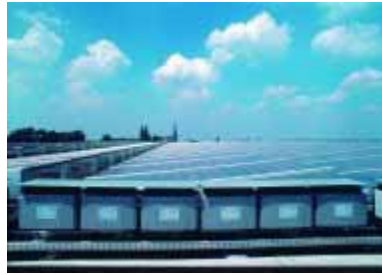
Figura 5.8 - Inversores de fileira de módulos ao longo do sistema fotovoltaico de Herne Fotografia: Flabeg
