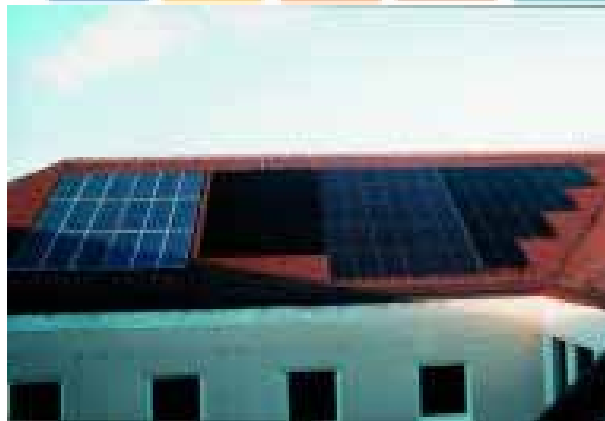
Figura 2.92 - Instalação fotovoltaica com módulos que utilizam várias tecnologias de células solares no Colégio Weihenstephan (Alemanha). Da esquerda para a direita: policristalino, monocristalino, CIS, amorfo, Telurieto de Cádmiio, sendo cada um de aprox. 1 kWp Fotografia: Soltec
