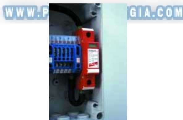
Figura 5.27 - Descarregador de sobretensões
