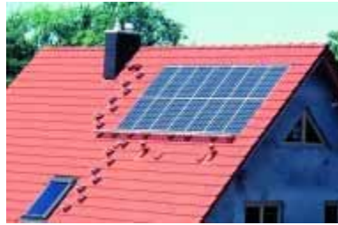
Figura 2.16 – Sistema fotovoltaico ligado à rede, instalado no telhado de uma casa familiar Imagem: ENERGIEBISS
