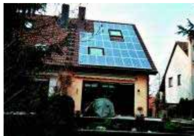
Figura 9.18 – Gerador fotovoltaico completo
