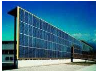
Figura 8.170 - Sede de Doma em Satteins, na Áustria Fachada com sistema combinado solar térmico (fachada quente) e fotovoltaico (fachada fria)
