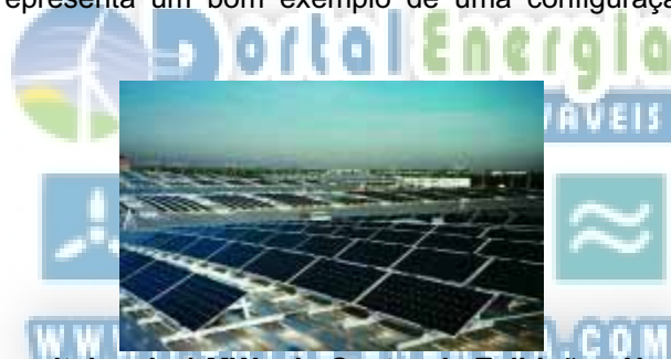
Figura 5.5 - Sistema fotovoltaico de 1 MWp do Centro de Exibições Neue Messe München, em Munique
