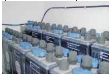
Figura 3.113 - Sistema de acumulação de Mindelheimer Hütte (nos Alpes). O nível do electrólito é facilmente verificado pelas marcas na caixa transparente da bateria
