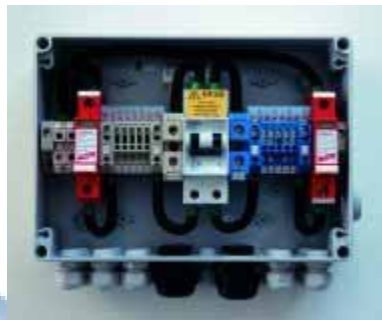
Figura 3.78 - Caixa de junção do gerador
