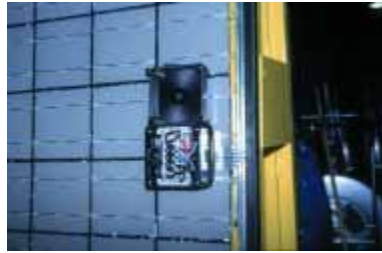
Figura 3.45 - Saída dos cabos com a caixa de junção do módulo no lado posterior
