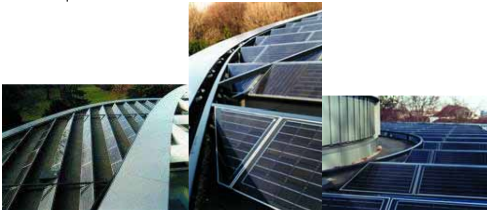
Figura 8.122 - Fixação de sistemas fotovoltaicos no telhado do Edifício do gabinete da presidência alemã, em Berlim
