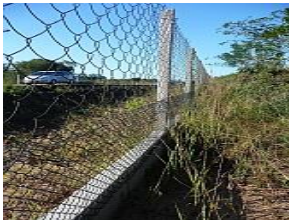
Figura 6. Cerca com base em concreto e tela em malhas progressivas na BR 101/RS. Foto: Mozart Lauxen.
