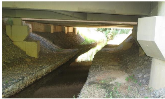
Figura 19. Vão de ponte com as laterais secas junto às cabeceiras para passagem de fauna na BR-101/RJ. Foto: Helio Secco.
