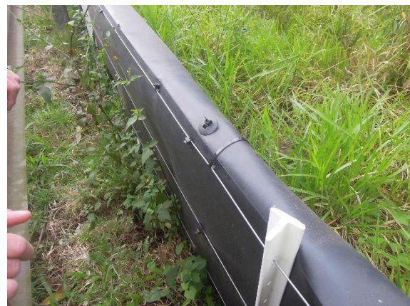
Figura 10. Cerca com plástico durável para anfíbios. Note a extremidade superior dobrada para evitar fuga de animais para a pista. Foto: Caroline Zank.
