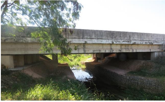
Figura 16. Vão de ponte com as laterais secas junto às cabeceiras para passagem de fauna na BR-101/RJ. Foto: Helio Secco.
